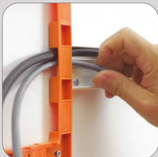
Passage pour câbles
