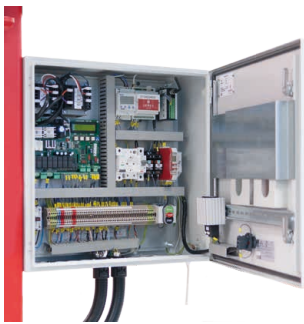
Armoire de contrôle
